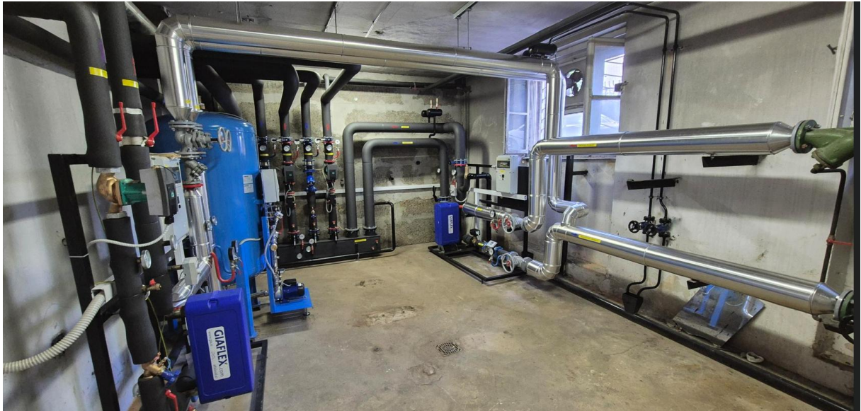
Dom AK - toplotna postaja po prenovi
